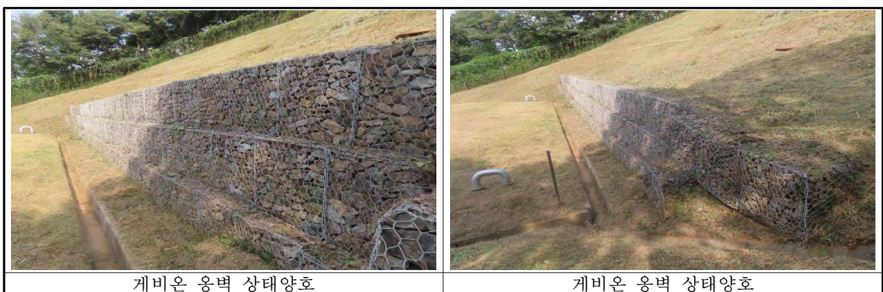
【사진 3.10】 옹벽 손상사진(계속)
