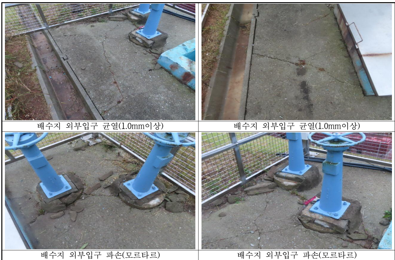
【사진 3.7】 배수지 외부입구 손상사진
